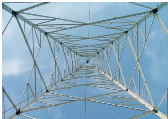
Linia elektroenergetyczna 220kV Janów-Piotrków
