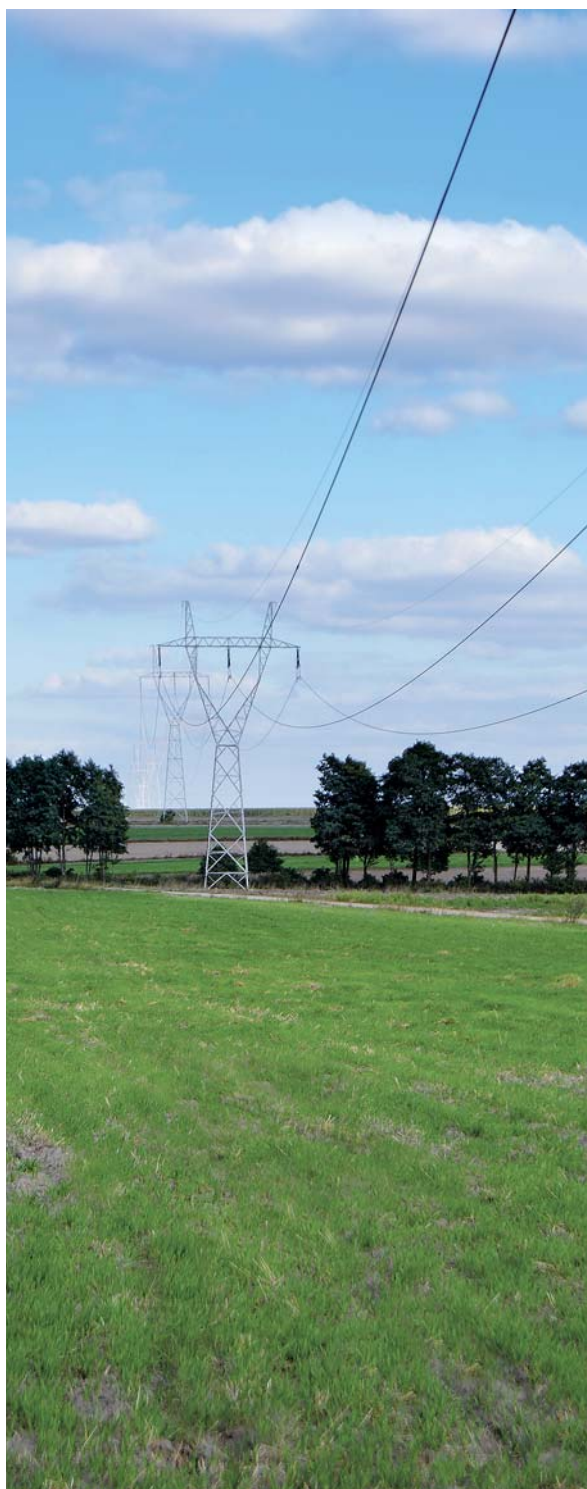
Linia elektroenergetyczna 220kV Janów-Piotrków
