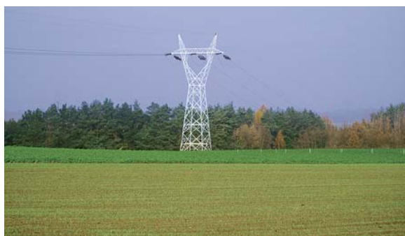
Linia elektroenergetyczna 220 kV Janów-Piotrków
