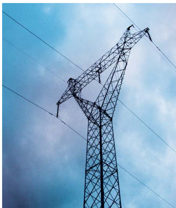
Linia elektroenergetyczna 220kV
