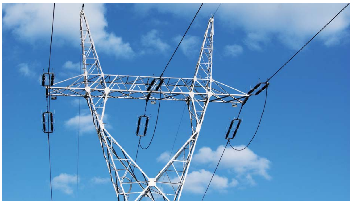
Linia elektroenergetyczna 220kV Janów-Piotrków
