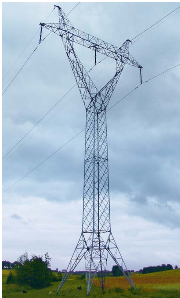
Linia elektroenergetyczna 220kV Janów-Piotrków
